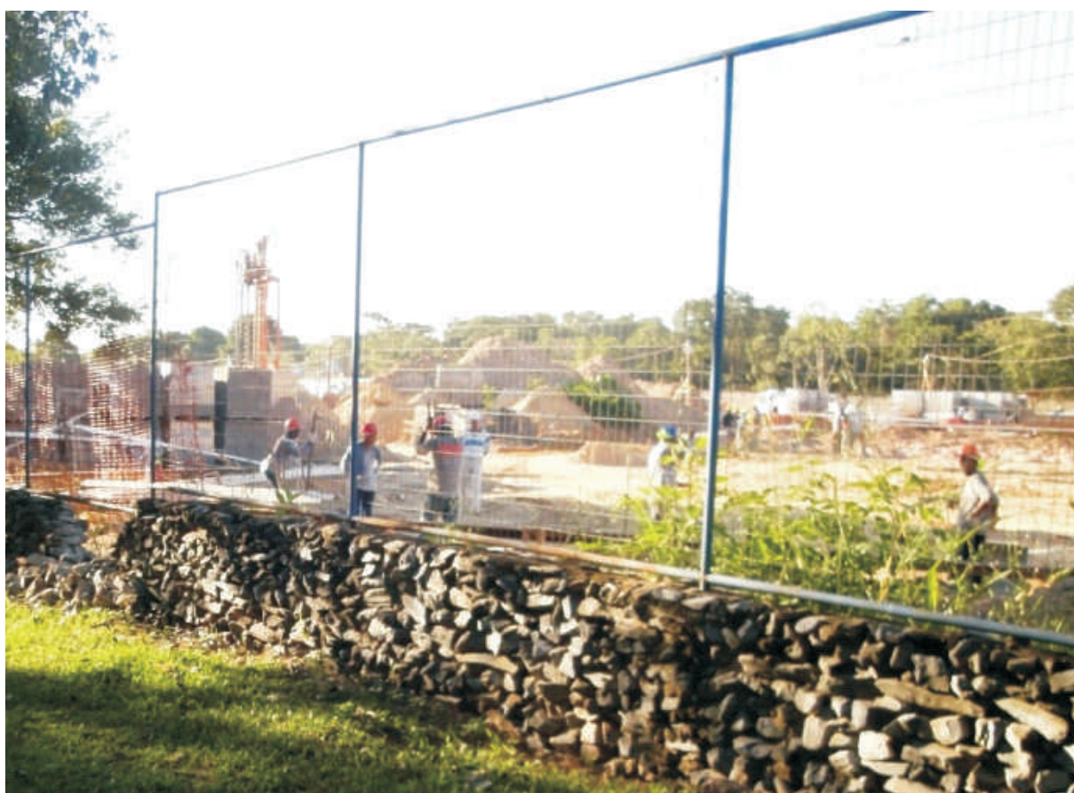
Figura 91 Canteiro de obras de edifício colocado no limite do Parque, em seu extremo ao norte, próximo à rua Antônio Doriléio.
