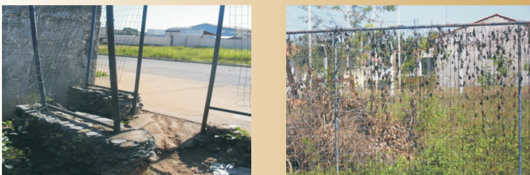
Figura 85 Condições de manutenção de alambrados e pontos de acesso para pedestres
