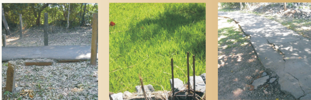
Figura 87 Estruturas danificadas ao longo de trilhas e limites do Parque sujeitando usuários a lesões físicas
